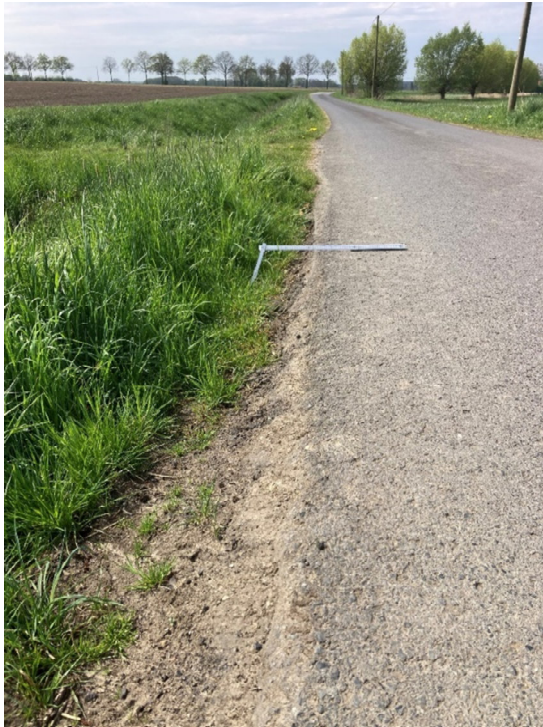
Foto 10: Höhenunterschied zw. Asphaltkante und Seitenbereich
